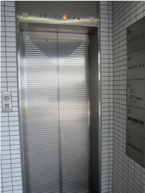
1Fエレベーター
