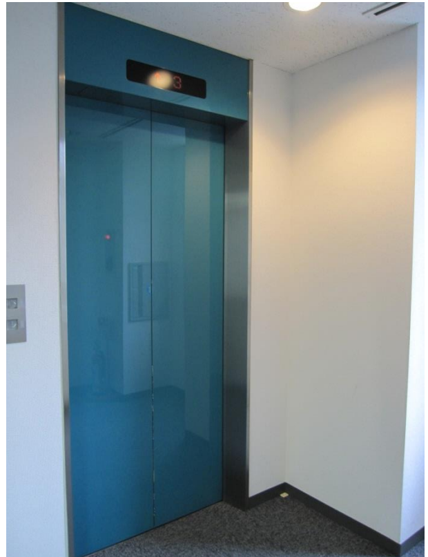
4Fエレベーター
